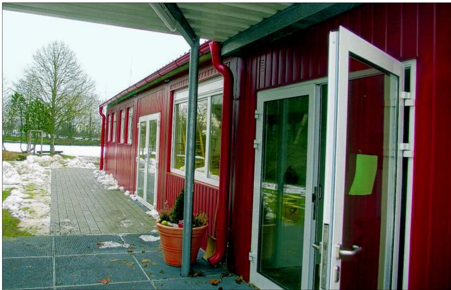
In den neuen Pavillon hat es hineingeregnet. Das Problem ist mittlerweile aber behoben. Unter akuter Platznot leidet die Möhringer Schule aber nach wie vor. Daher soll an den bereits bestehenden Interimsbau ein weiterer angeschlossen werden. Foto: Alexandra Kratz
